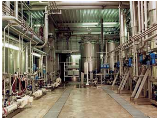
■ Komplettanlage mit einer Leistung von 120.000 l/h Stärkeleim
